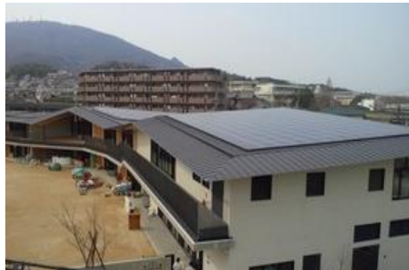
南こども園 FIT太陽光発電 (市民エネルギー生駒保有)
