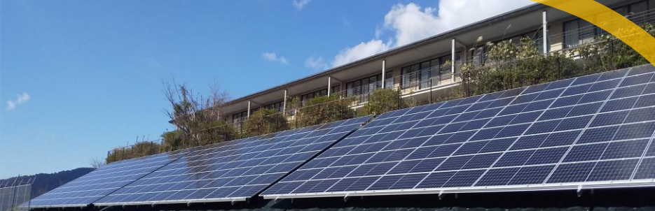
PPA 太陽光発電 やすらぎの杜優楽で全量自家消費 (市民エネルギー生駒保有)
